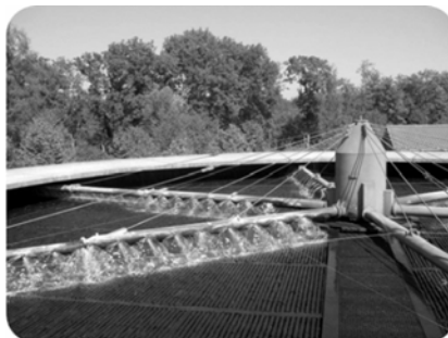
Filtro percolador (Bruns Umwelttechik, 2010)
