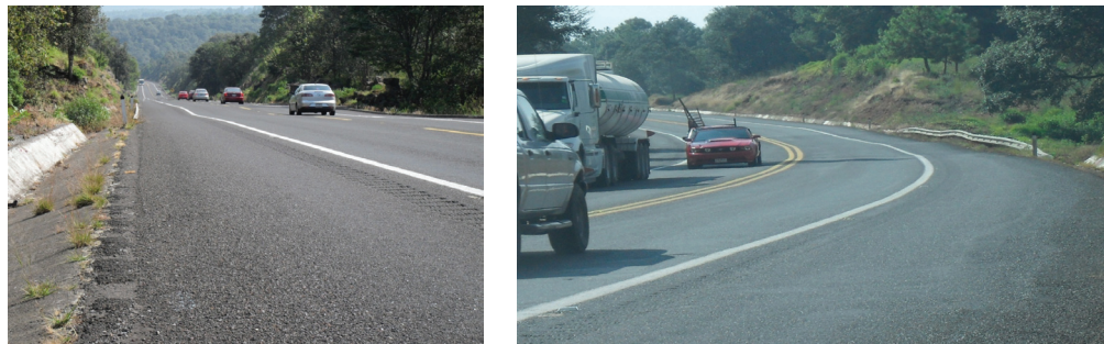
Figura 1. Problemática típica de asentamientos en la zona de la autopista
