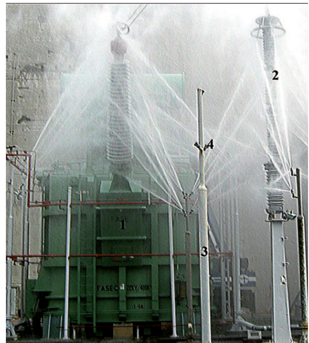
Figura 3. SLTFAP funcionando sobre un transformador monofásico de 300 MVA marca IEM con su pararrayo. 1) transformador marca IEM de 300MVA, 2) pararrayo del transformador, 3) poste de lavado y 4) boquilla de lavado
