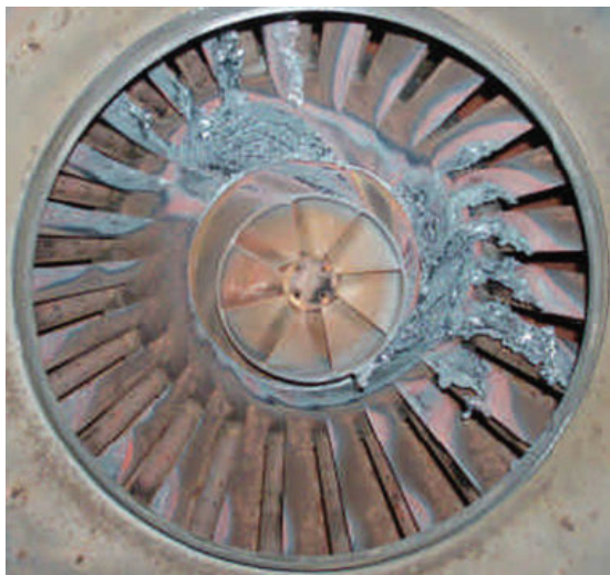
Figura. 1. Daño típico por reflujo de flama (Valera et al., 2010)
