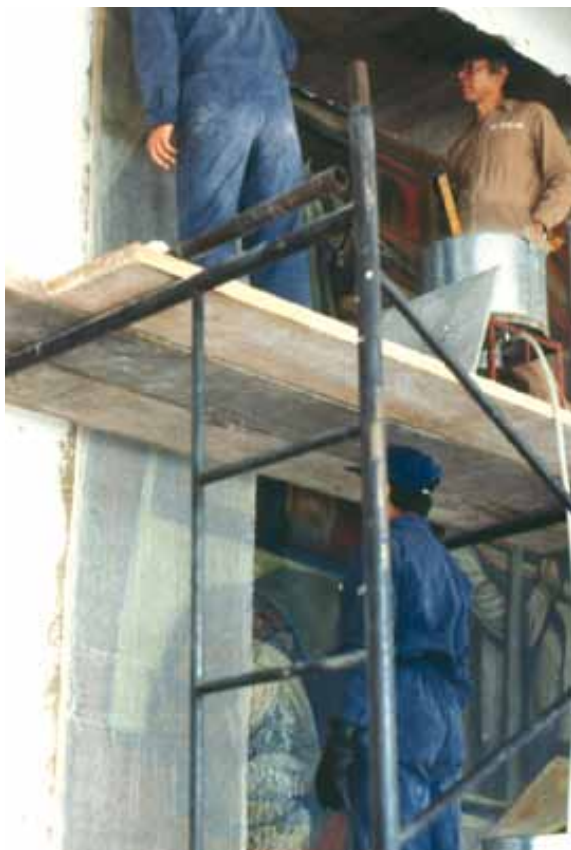
Procesos de desprendimiento del mural del pintor Alfredo Zalce en el Edificio de la Secretaría de Industria y Comercio, 1986.
