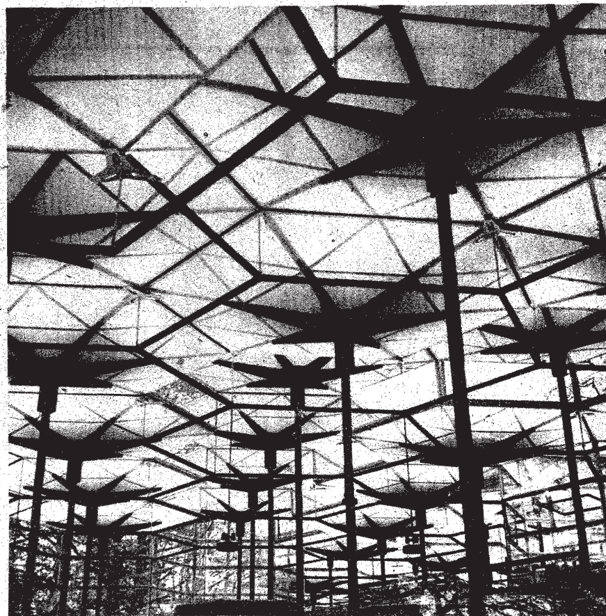
Un elemento ligero de cubierta, de forma exagonal, se repite para dar forma al pabellón español. Por las diferencias de nivel penetra la luz. Las columnas que soportan las sombrillas sirven también de desagüe.
