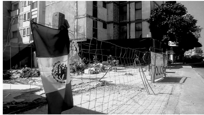
Colonia del Valle, Calle Torreón esquina con Viaducto Miguel Alemán. Edificio derrumbado. Fotografía: Carla Filipe
