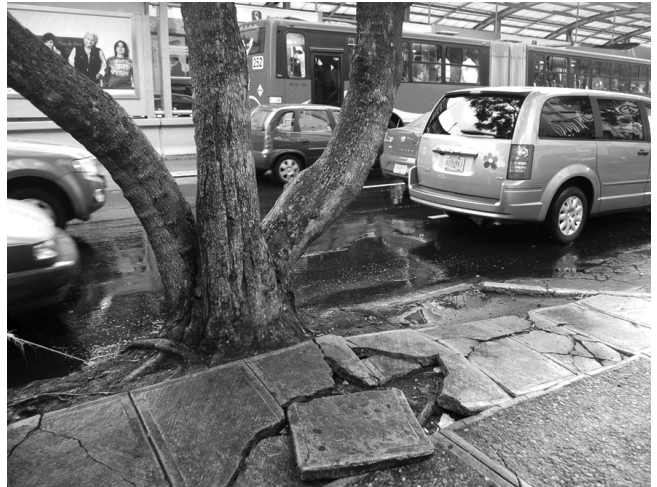
Obstaculización del espacio público de las aceras por los árboles. Fotografía: Lorena Fainkuchen
