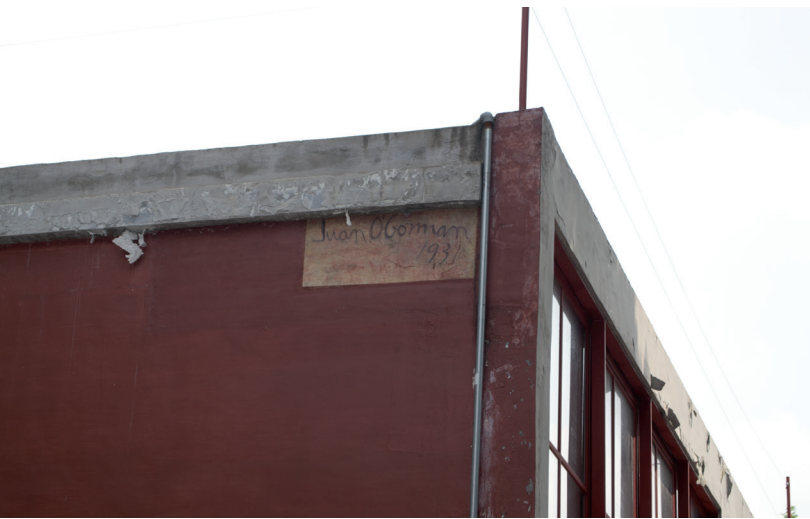
Fachada sur de la casa O'Gorman y detalle de la firma. Fotografías: José Manuel Márquez Corona
