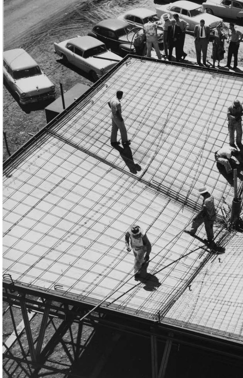
Montando la prueba del primer paraguas americano en Colorado. Archivo de Félix Candela en la Avery Architectural and Fine Arts Library de Columbia University Fuente: FCARP
