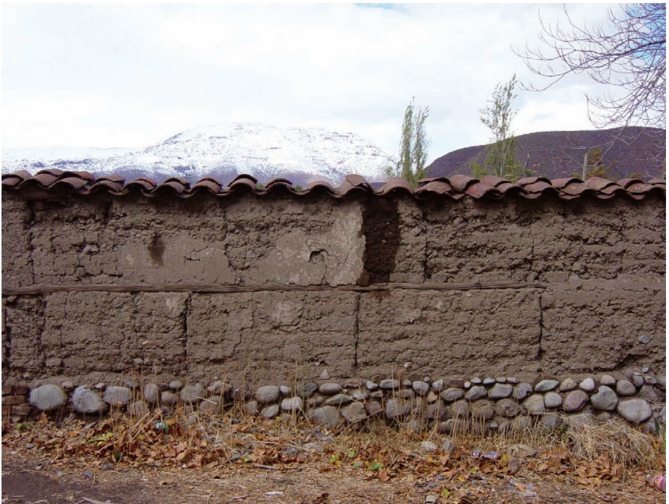
Tapias agrietadas por el uso de tierras arcillosas. Valle de Aconcagua, Chile. Fotografía: Luis F. Guerrero
