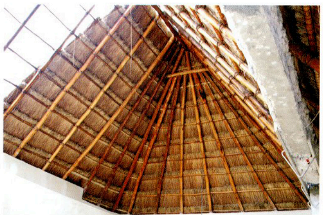
Cubierta en construcción de rollizos y pasto de ciénega Fotografía: Salvador Reyes-Rios
