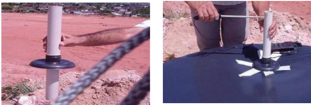
Figura 8. Etapas do monitoramento de gás nos drenos.
