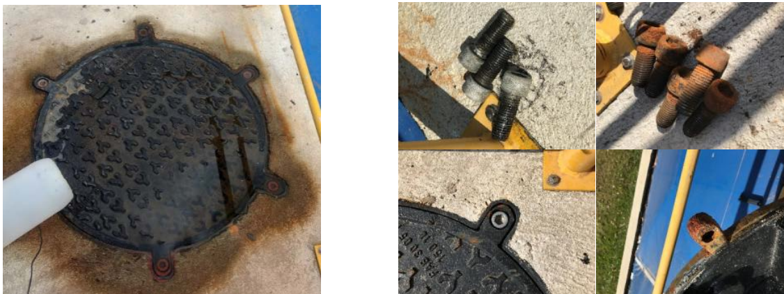
Figura 10. Condição diferenciada de corrosão das tampas de ferro fundido utilizadas no reator antigo.
