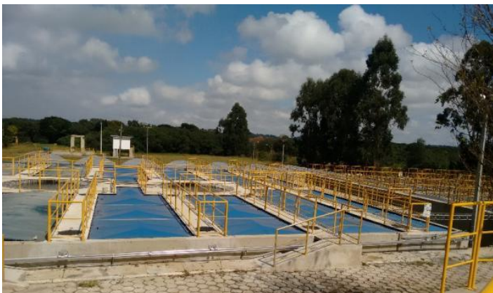
a) Reator Antigo com tampas de ferro fundido nodular no gasômetro e tampas de plástico com estrutura em alumínio nas canaletas de decantação
