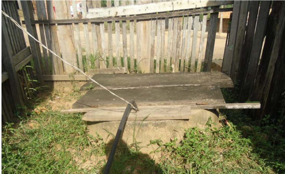
Figura 2. Vedação inadequada de poço do bairro Beira Rio. Fuente: Autores, 2018.
