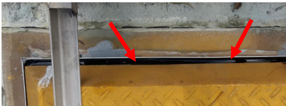
Figura 7. Acúmulo de água de chuva nas tampas da câmara de gás do reator novo.
