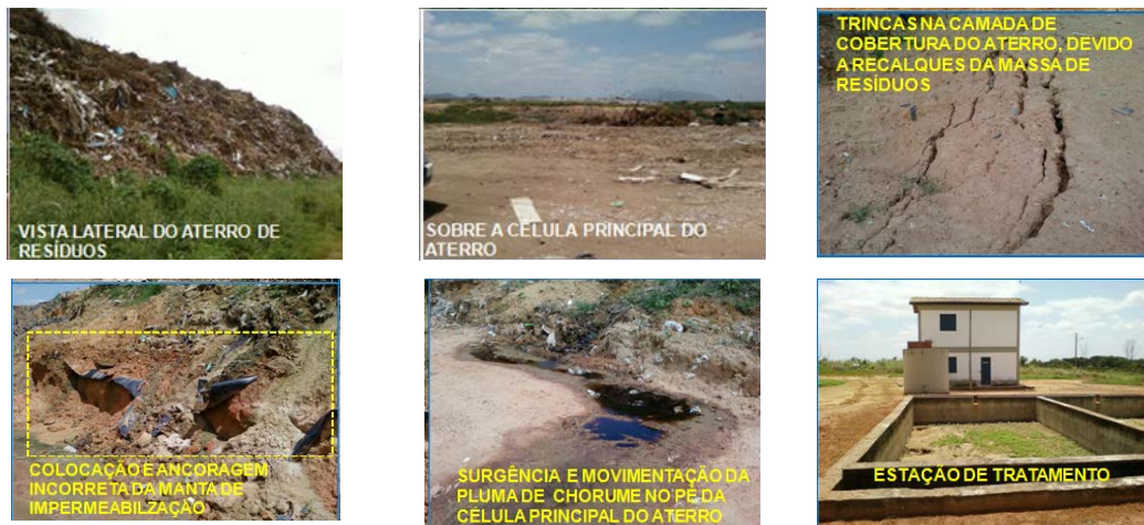
Figura 3. Falhas observadas no aterro sanitário de Boa Vista/RR.
