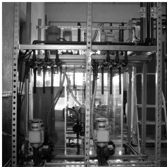
Figura 1. Vista frontal de la planta piloto de electrocoagulación
