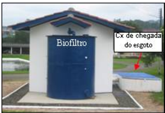
FIGURA 1: Biofiltro para tratamento dos odores gerados na ETE de Orleans.
