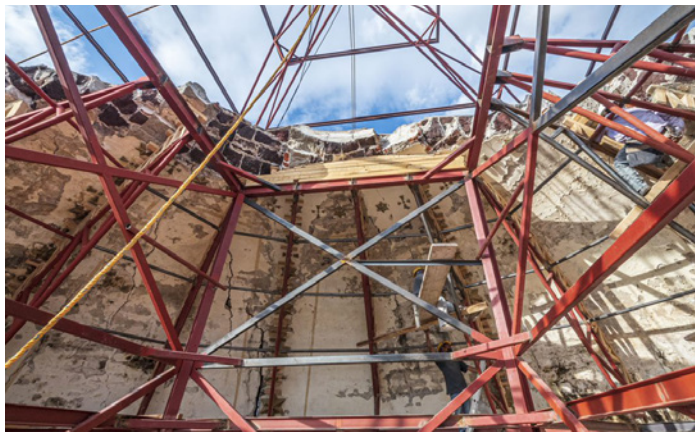
El borde libre que quedó de la zona del brocal de la linterna se recibe con polines de madera, para impedir una cadena de fallas. Fotografía: EDTE y RESC.
