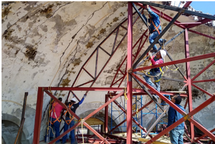
Proceso de colocación de las cerchas metálicas para tomar la curvatura de los plementos del casquete esférico del mejor modo posible. Fotografía: EDTE y RESC.
