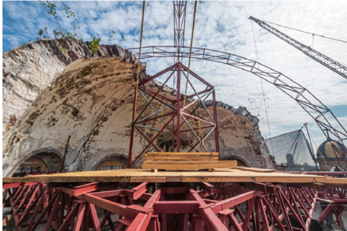
Colocación del apoyo central que encaja sobre la tapa del hiperboloide, enrasada con la plataforma de triplay de \frac{3}{4} de espesor. Fotografía: EDTE y RESC.
