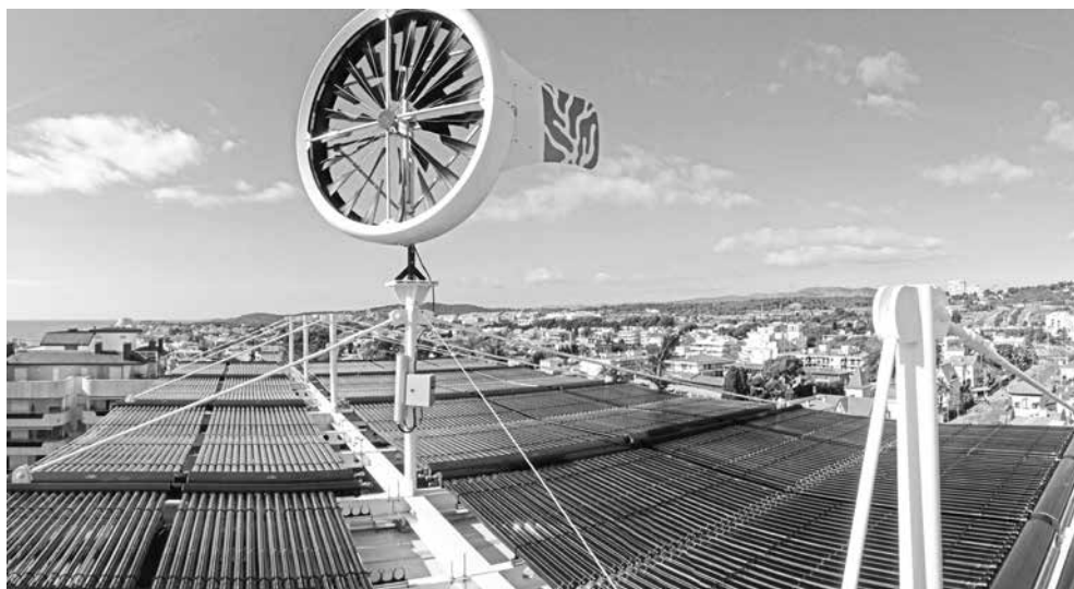
Cubierta con aerogenerador eólico, y calentadores de agua solares. Hotel Boutique & Spa. , en Sitges, España
